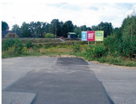
Asfaltbetona segums pēc remonta
