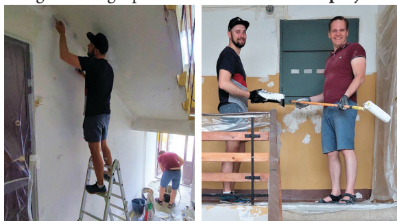
NIG "Pirmā iela 27" projekta "Daudzdzīvokļu mājas Pirmā iela 27 otrās kāpņu telpas remonts" īstenošana.
